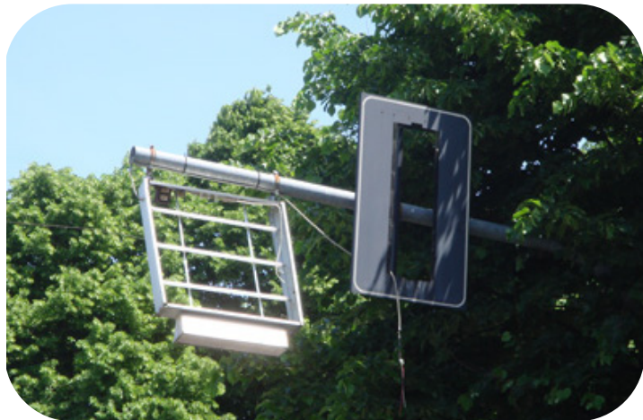
Dettaglio del semaforo danneggiato
